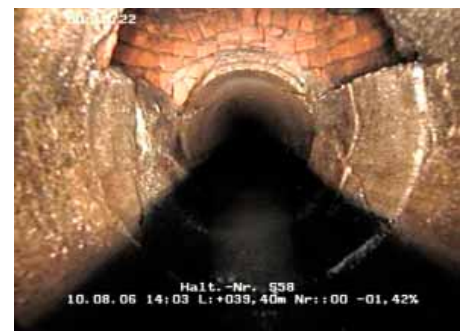
Schadhafter Kanal im Schachtbereich
