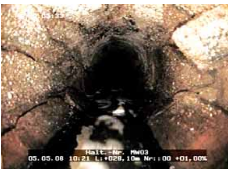
Kanalbruch in Zschornowitz vor der Sanierung
