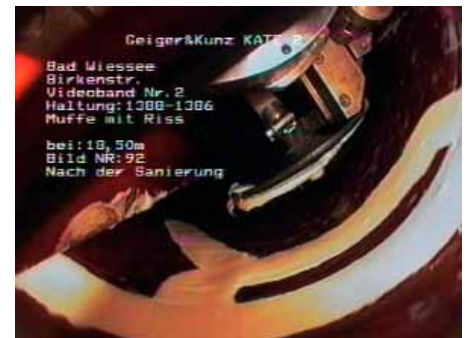
Sanierte Schadstelle Muffe mit Rissen.
